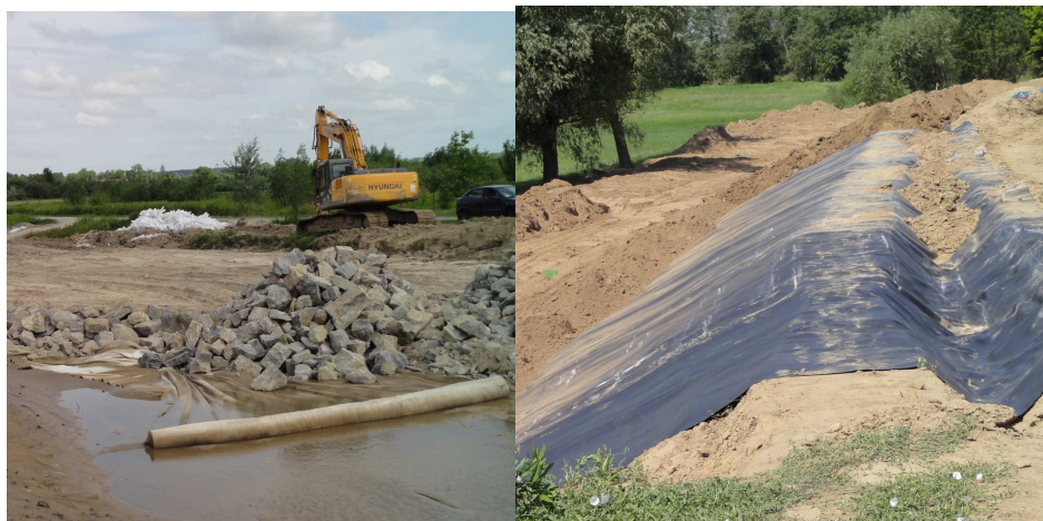
Rys. 5. Realizacja filtra odwrotnego na zawalu oraz ekranu z geomembrany dwustronnie uszorstkowanej firmy Gamrat (fot. autora).
