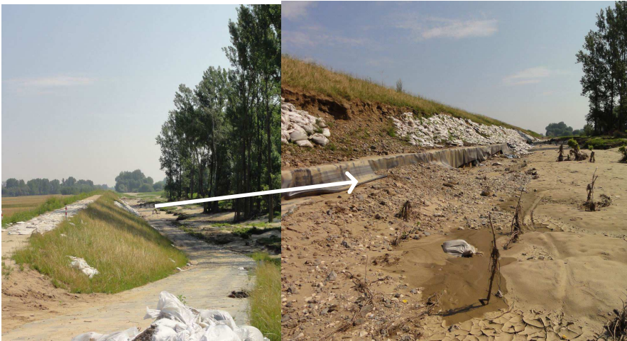
Rys. 2. Uszkodzenia stopy i skarpy omawianego lewobrzeżnego wału Wisły, odcinek 1-szy (fot. autora)
