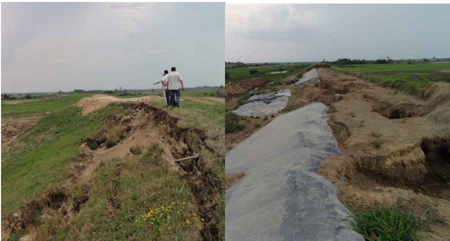
Rys. 6. Różne fazy uszkodzenia wału spowodowane przelaniem się fali z zawala (fot. autora).
