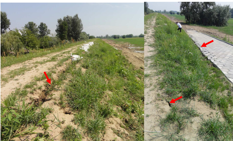
Rys. 3. Uszkodzenia omawianego lewobrzeżnego wału Wisły, odcinek 2-gi (fot. autora).
